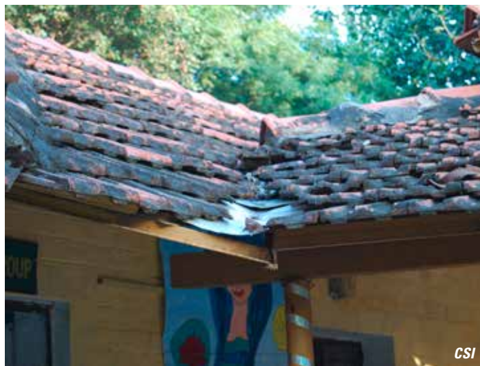
Das alte Dach muss unbedingt erneuert werden.
